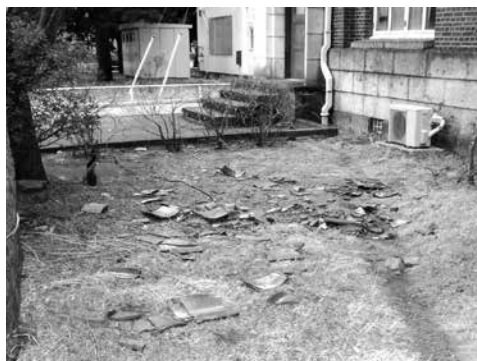
屋根瓦の散乱情況
